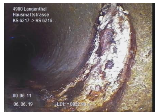
Abbildung 6: Rohrwandung stark verkalkt
