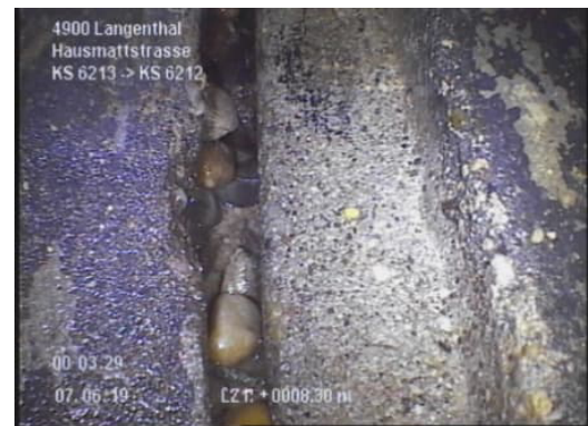
Abbildung 8: Muffe stark versetzt und geöffnet
