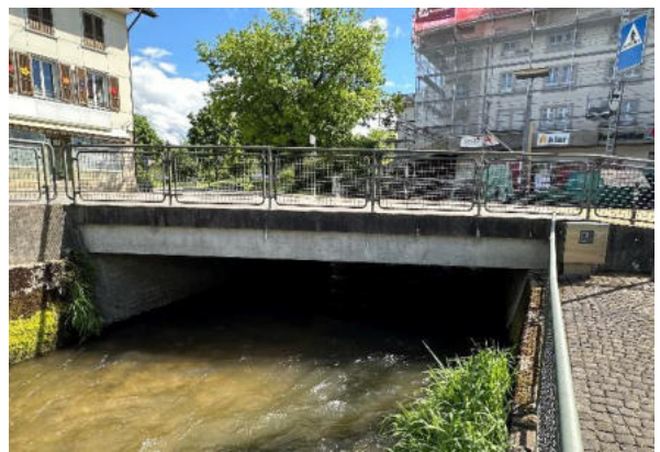
Exponierte Betonoberfläche stark verwittert Konsolkopf unterwasserseitig
