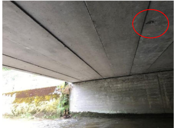
Abplatzung Untersicht Elementträger
