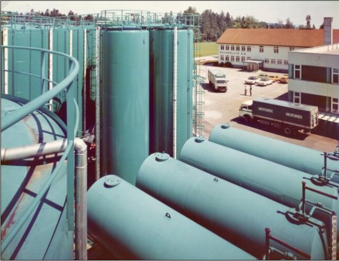
Abbildung 8: Sicht auf die neu errichteten Stehtanks [33]
