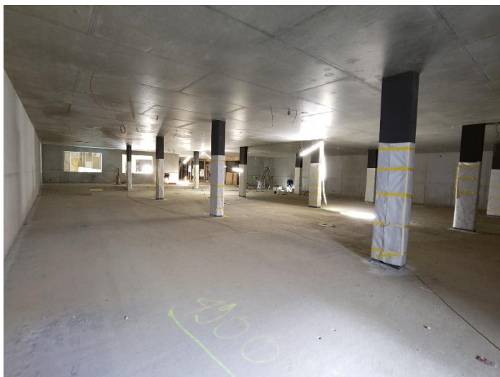
Abbildung 1: Der Innenausbau der Velostation Süd im Untergeschoss des Bahnhofs startet, inkl. dem Ausbau der neuen Velowerkstatt, welche im Hintergrund zu sehen ist.
